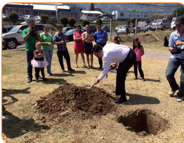
El Ministro de Trabajo, Olman Segura Bonilla, participó en la colocación de la primera piedra de lo que será el nuevo CECUDI de San Antonio de Escazú.
